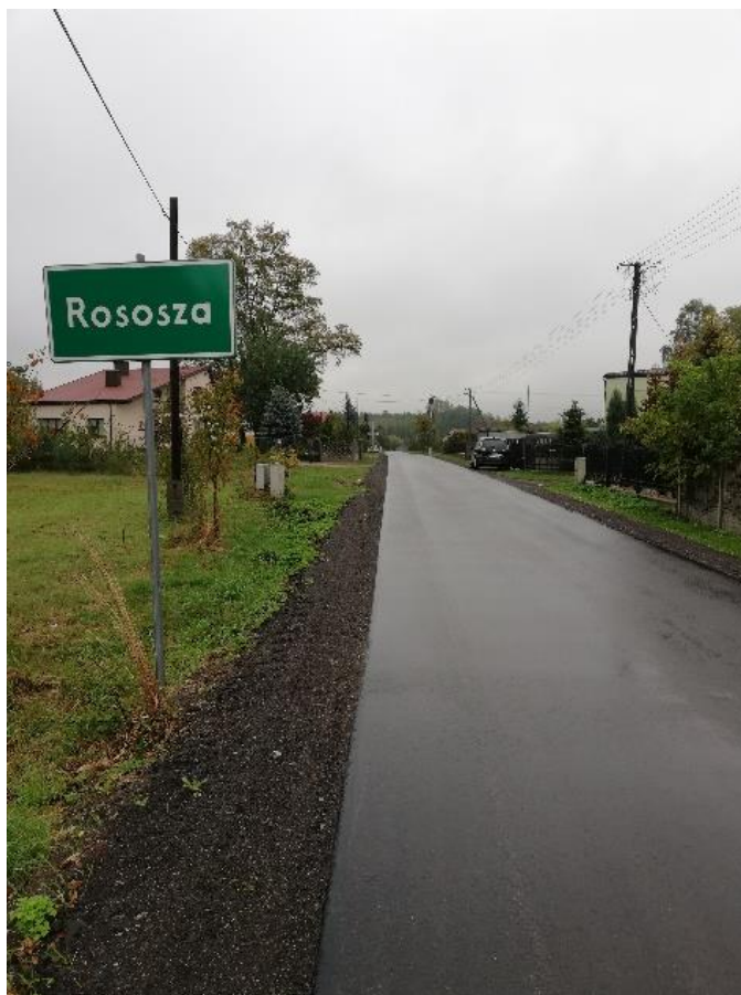
Remont drogi gminnej nr 103057E Rososza – Piguła” na odcinku 0,830 km o wartości 243.494,24 zł z dofinansowaniem Wojewody Łódzkiego w wysokości 80% kosztów kwalifikowanych
